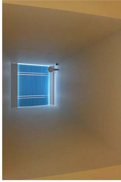
自然排煙口 閉鎖状況 排煙口付近の光電式感知器
