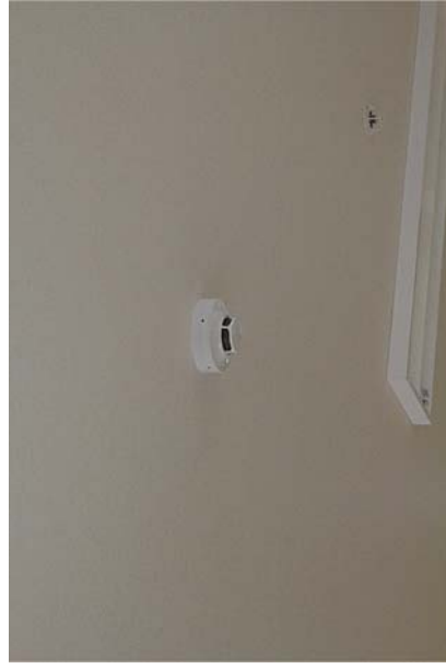
天井設置の光電式煙感知器
