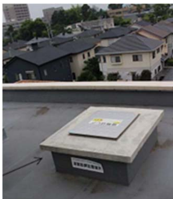
写真 18 本館屋上避難はしごの設置状況
