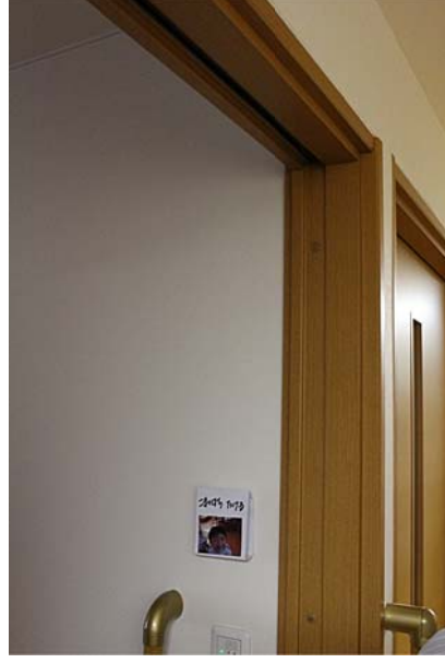
個室の扉の閉鎖部分の状況
