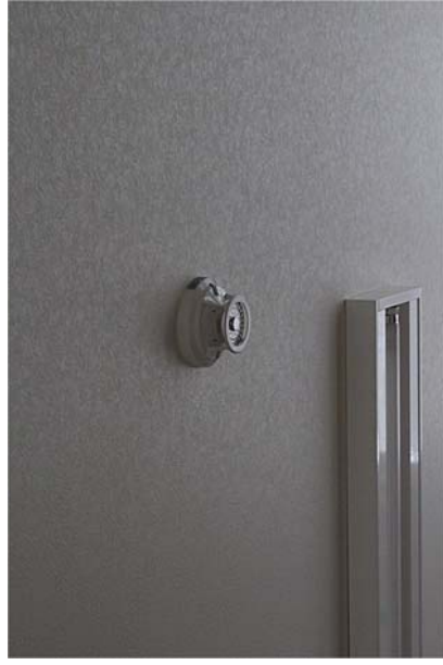
厨房エリア上部天井設置の定温式熱感知器
