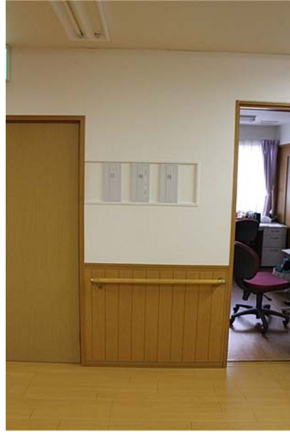
自然排煙口 開放操作部
