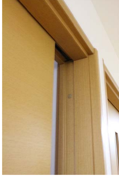
個室の扉の閉鎖部分の状況
