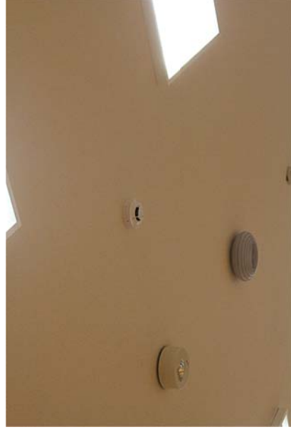
天井設置の光電式煙感知器
