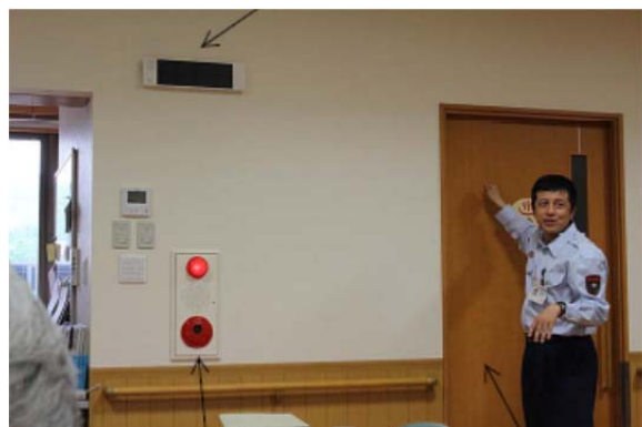
写真 17 呼び出し表示器、自動火災報知用発信器（火災通報装置との連動無し）
