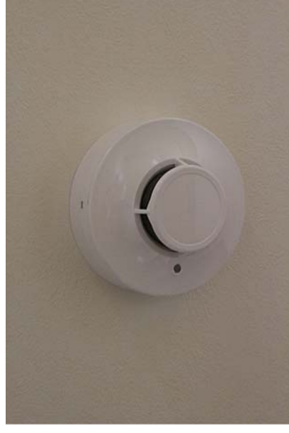
天井設置の光電式煙感知器
