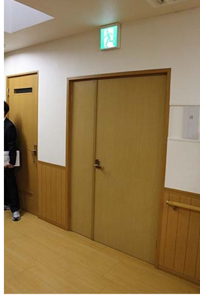
出入口上部の高輝度誘導灯
