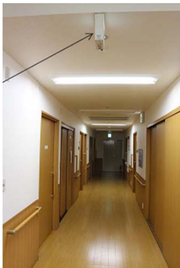
写真 16 別館通路部分と通路誘導灯
