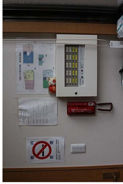
火災通報装置 自動火災報知設備 副表示機
