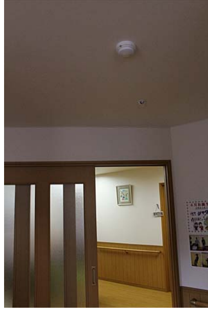
天井設置の差動式熱感知器 (玄関)
