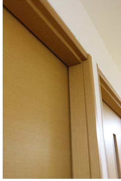
個室の扉の閉鎖部分の状況
