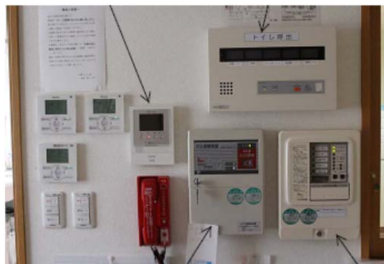
写真 19 管理室（玄関インタホン、トイレ呼び出し、火災通報装置、自動火災報知設備(グループホーム用)
