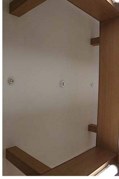
天井設置の非常用照明器具 光電式煙感知器など
