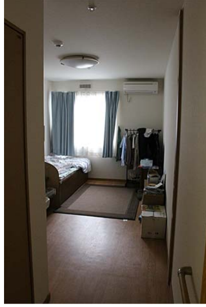
個室の天井設置の光電式煙感知器 水道直結型スプリンクラーヘッド
