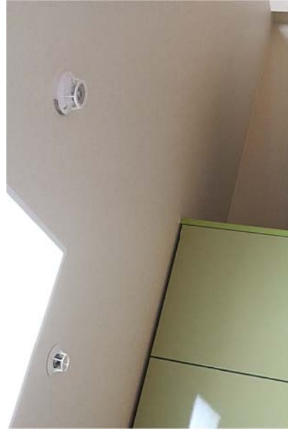
水道直結型スプリンクラーヘッド 厨房エリアの定温式熱感知器
