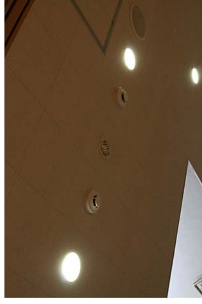
内部階段の光電式煙感知器（連動用）
