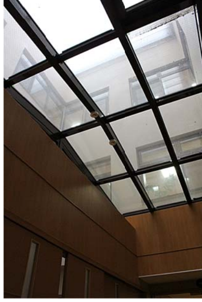
吹き抜け下部の光電式煙感知器（連動用）
