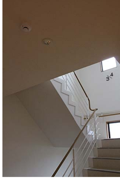
天井設置の光電式煙感知器
